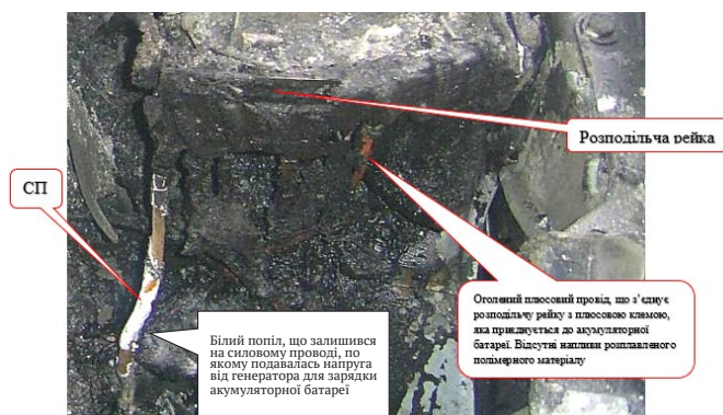
Рисунок 2. Фрагмент блоку, в якому встановлені реле та електрозапобіжники у моторному відсіку
